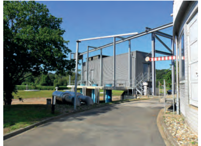
Bild 16.2: Das neu erstellte Rohwasser II Pumpwerk Fig. 16.2: The newly established raw water pumping station II
