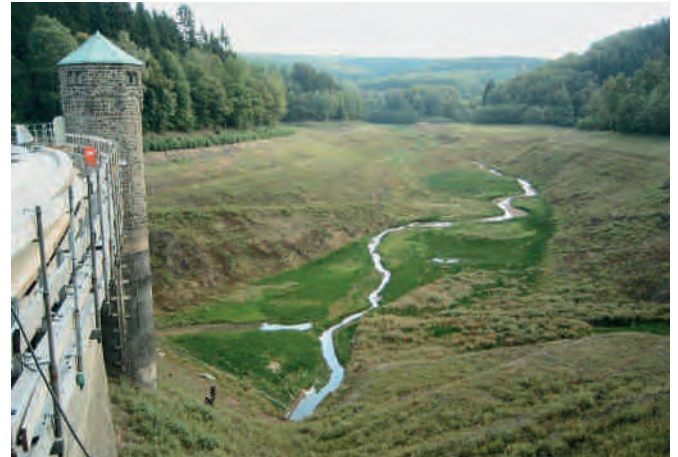
Bild 7.2: Leere Fürwiggetalsperre mit Pflanzenbewuchs im Jahr 2006 Fig. 7.2: The empty Fürwigge Reservoir with vegetation, 2006
