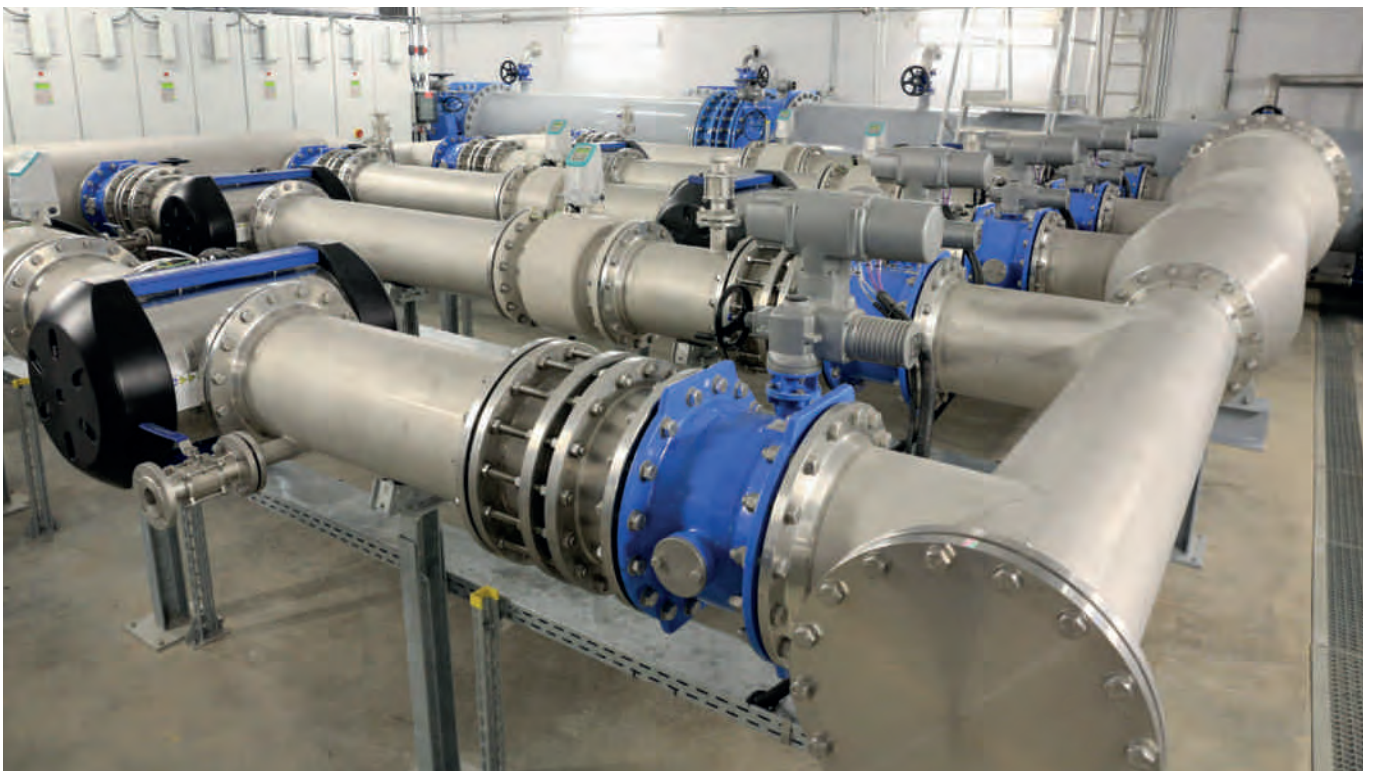
Bild 16.5: Ein Teil der UV-Anlage für das Pumpwerk I zur Versorgung des Stadtgebietes Essen Fig. 16.5: Part of the UV facility for the pumping station I, supplying the city of Essen
