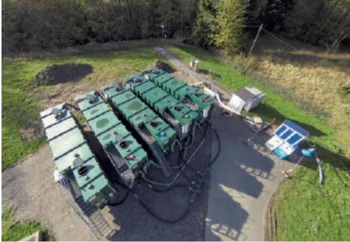
Bild 7.3: Chemische Desinfektion am Ablauf der Kläranlage Warstein Fig. 7.3: Chemical disinfection at the outlet of the Warstein sewage treatment plant
