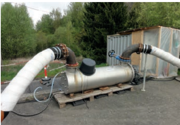
Bild 7.2: UV-Anlage am Ablauf der Kläranlage Warstein Fig. 7.2: UV facility at the outlet of the Warstein sewage treatment plant
