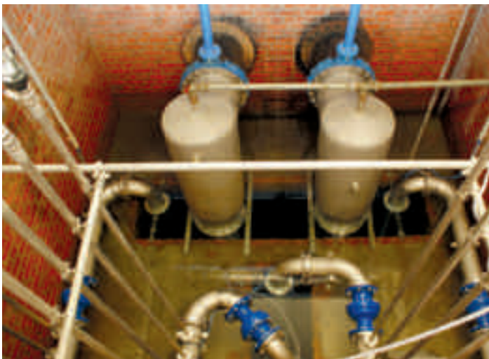
Bild 16.3: Sammelbrunnen Fig. 16.3: Collection tank
