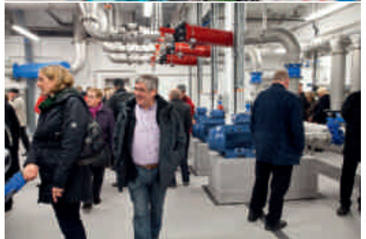
Bild 17.5: Das Wasserwerk als Begegnungsort für die Bürger und Partner beider Stadtwerke Fröndenberg und Menden.
