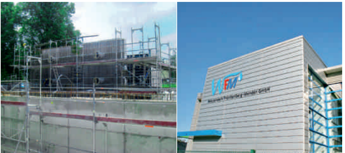
Bild 17.2: Nach nur 18 Monaten Umsetzungszeit erfolgte die Inbetriebnahme der neuen Wasseraufbereitungsanlage der Wasserwerk Fröndenberg-Menden GmbH.
