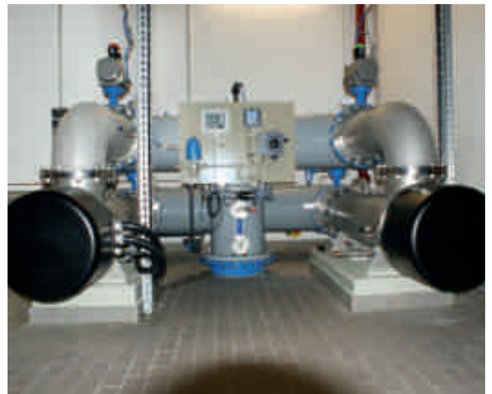
Bild 16.7: UV-Anlage Fig. 16.7: UV facility
