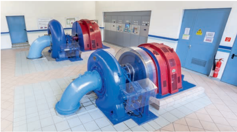
Blick in die Turbinenhalle des Hennekraftwerks.
