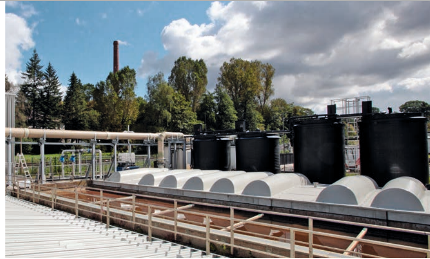
Hochlastbiologie mit Zwischenklärung
