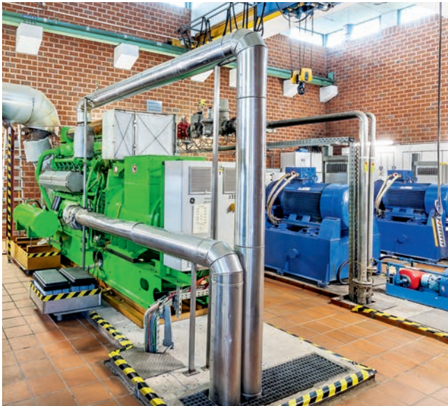
Blockheizkraftwerk (grün, links im Bild) und Turboverdichter (blau)
