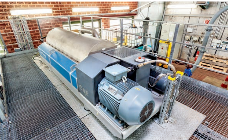
Zentrifuge zur Schlammentwässerung
