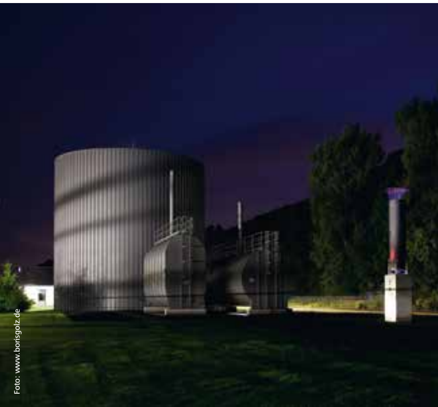
Schlammbehandlung mit Gasbehälter und Gasfackel
