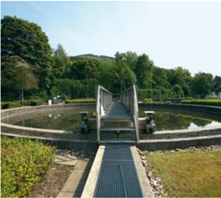
Die Nachklärung besteht aus zwei Rundbecken.
