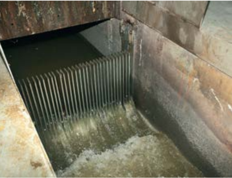
In der Rechenanlage werden Grobstoffe zurückgehalten.
