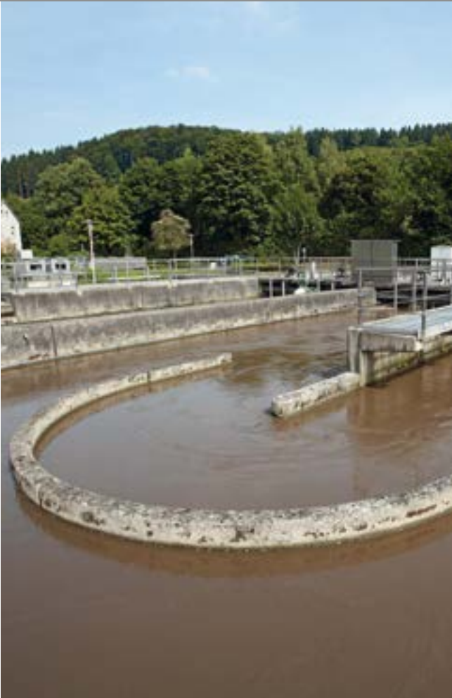
Die Belebungsbecken sind das Herzstück der Anlage.
