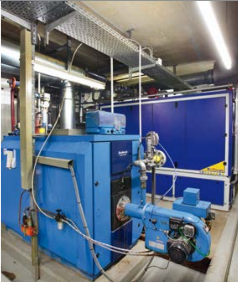
Ein Blockheizkraftwerk (BHKW) versorgt die Kläranlage mit Strom und Wärme.
