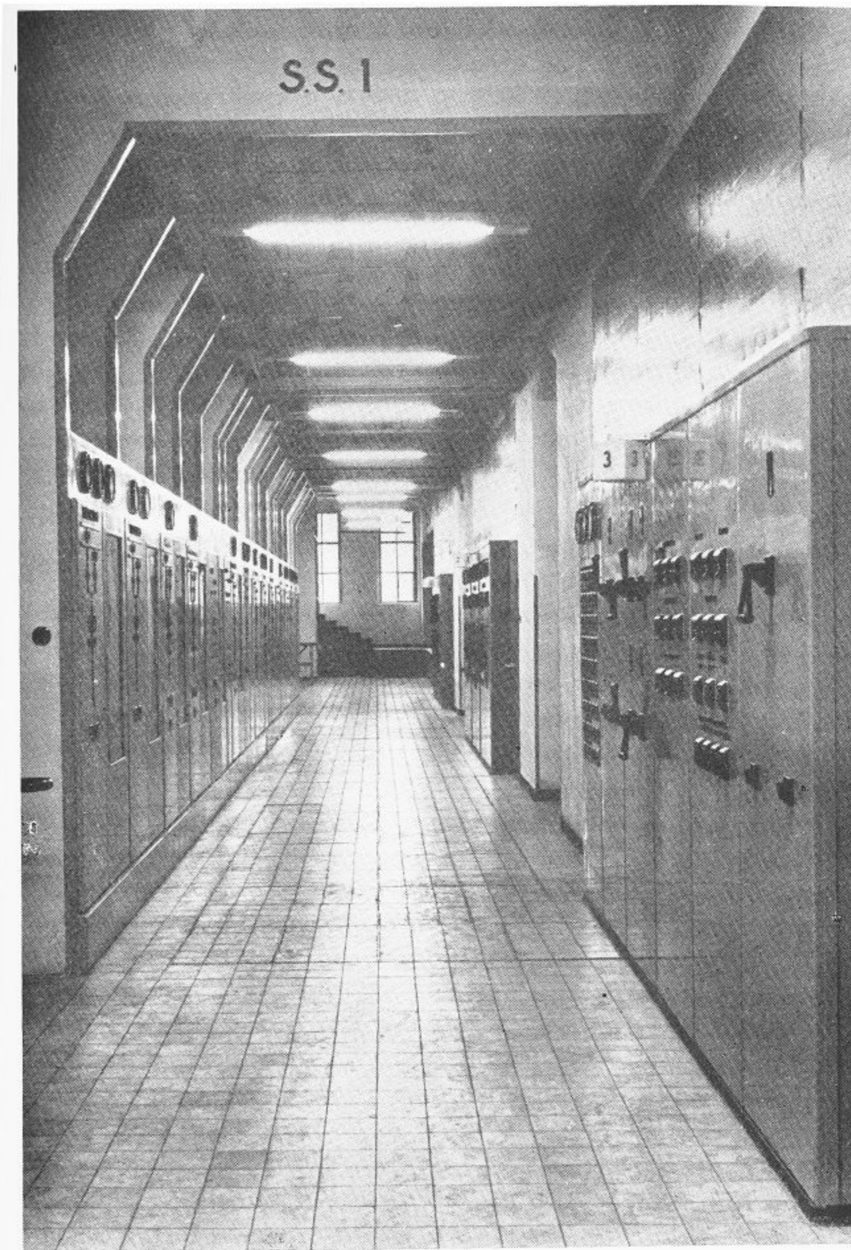
Hauptbedienungsgang im Kraftwerk
