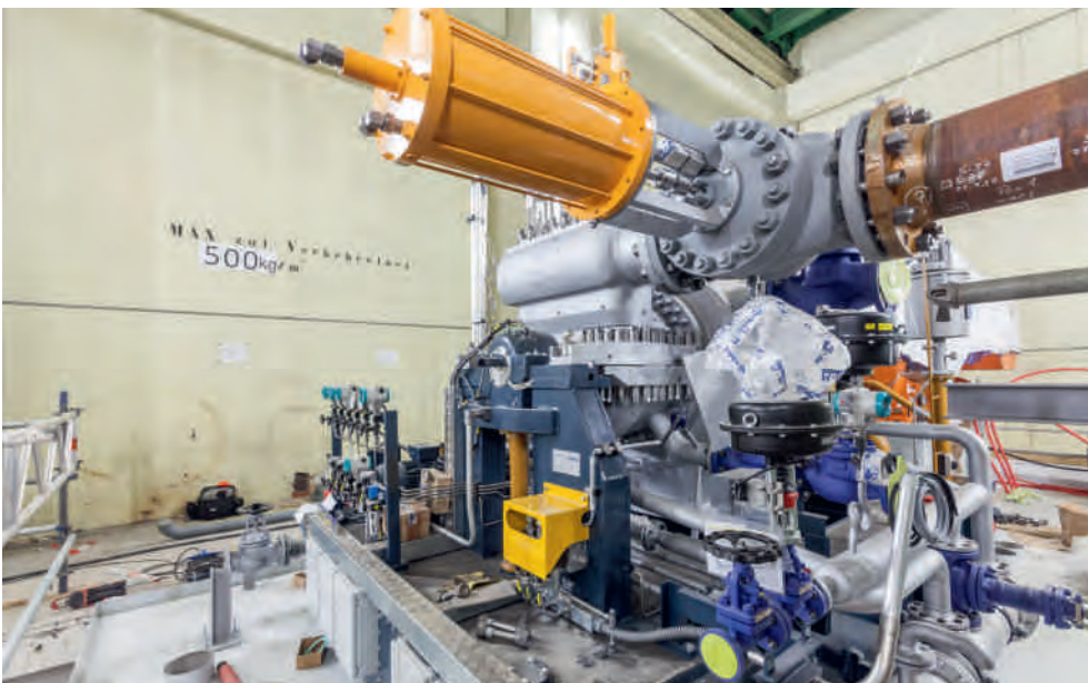
Die neue Dampfturbine mit Generator (Bild aus der Bauphase) leistet knapp vier Megawatt. Damit kann die WFA E vollständig mit Strom versorgt werden.
