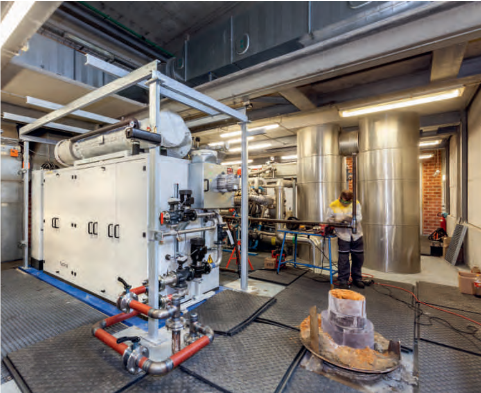
Auf mehreren Kläranlagen des Ruhrverbands fanden im Jahr 2017 Repowering-Maßnahmen statt. Dank der neuen Aggregate wird die Eigenstromerzeugung deutlich gesteigert.
